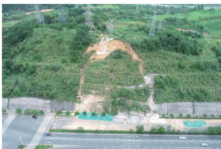
图1 滑坡全貌 Fig. 1 Landslide panorama
