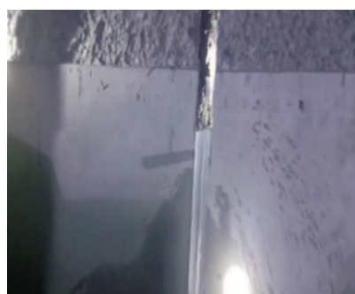
(a) 车站机电层渗漏照片
