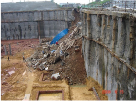
图1 某膨胀土基坑倒塌
