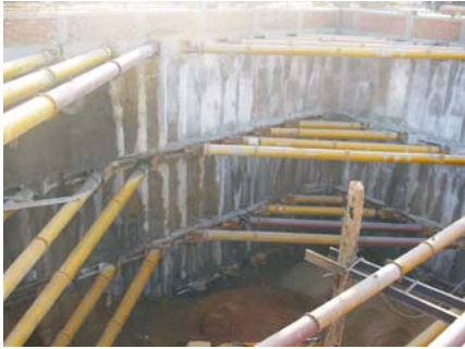
图 14 坍塌前基坑南侧情况
