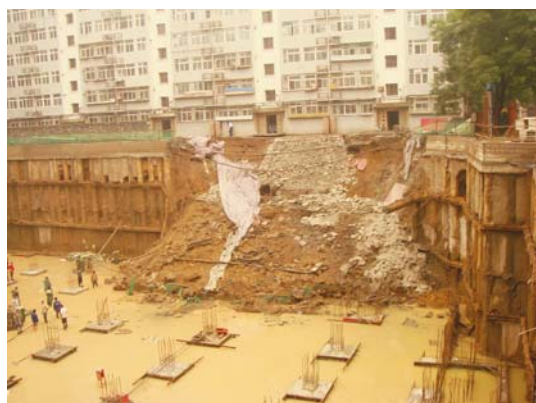
图 10 基坑坍塌情况
