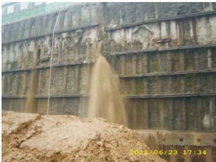
图 16 基坑涌水情况
