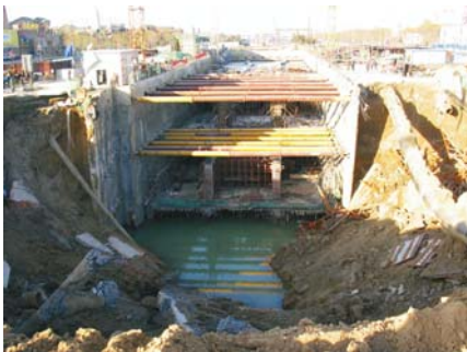
图 15 坍塌后南向北情况
