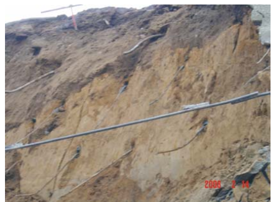
图9 基坑塌方土钉头拉断,土钉完整
