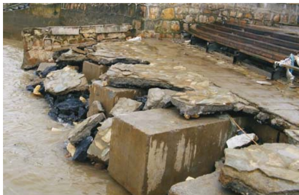
图 1 亲水平台塌陷
