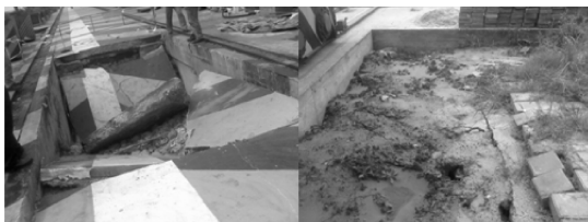
图 1 塌陷现场照片
