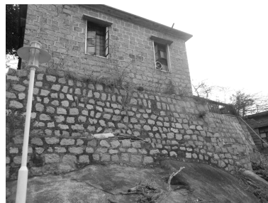
图 2 潜在不稳定墙体
