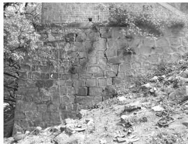
图 1 潜在不稳定墙体
