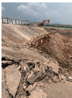
图5 隆起段现场图(镜向N, 基坑位于照片右侧)
