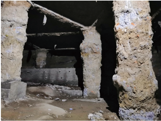
图3 现场裸露桩基
