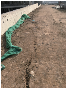
图 8 道路地面裂缝
