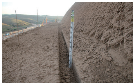
(b) 排水沟淤堵实例
