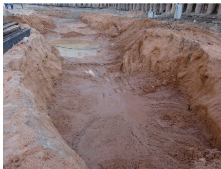
图1 透水性砂岩中的渗透破坏
