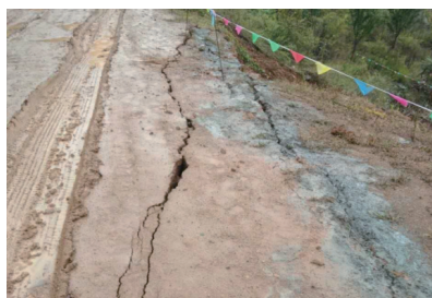
图 4 边坡上部外缘的地裂缝
