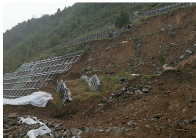
图 2 边坡垮塌后的现状
