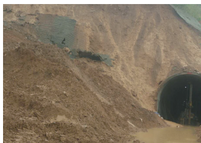
图 3 边坡垮塌掩埋隧道洞口现状
