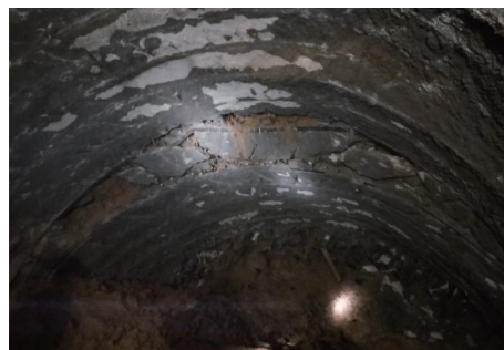
图4 初期支护拱顶下沉
