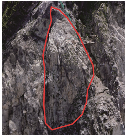
图4 3号危岩体航拍图
