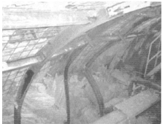
图 4 第二次岩爆塌方左侧拱架破坏情况
