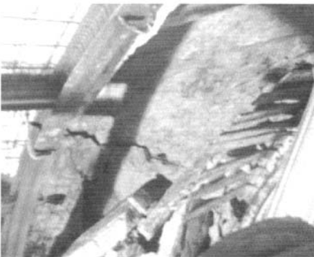
图6 SK14+230~SK14+222段岩爆塌方产生的塌腔
