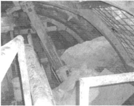
图5 塌方落下的石块卡住了锚杆钻机
