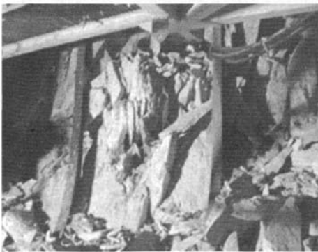
图 2 塌坑附近边墙下部破坏情况
