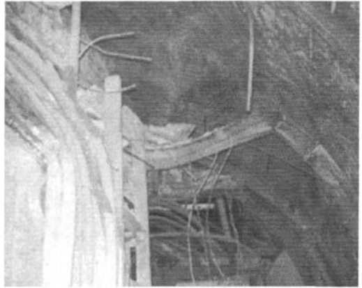
图 3 右侧拱顶位置塌方情况
